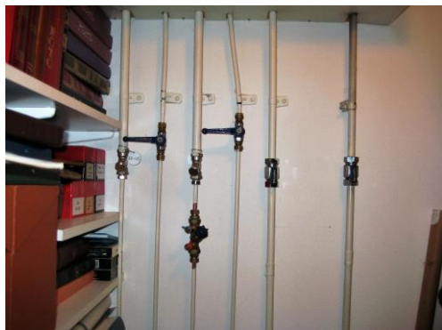
Placering av ventiler inne i klädkammaren i en 2 rumslägenhet, avstängningen för kall- och varmvattnet är de 2 högra ventilerna.
